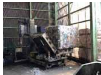
廃プラ圧縮梱包機
