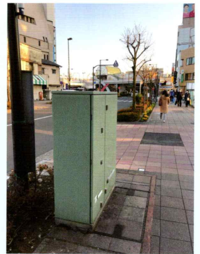
無電柱化された小作駅東口と地上設備
